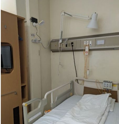
センサー設置状況
